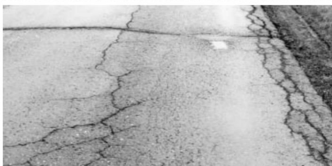
54-р зураг- Сул дэд суурьтай үед тээврийн хөдөлгөөний ачааллаар үүссэн ирмэгийн дагуух хагарал
