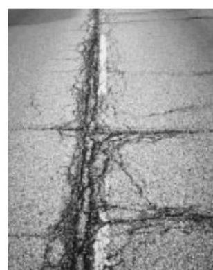
50-р зураг- Хагарлын завсараар ус орсноор хучилт эвдэрсэн байдал.
