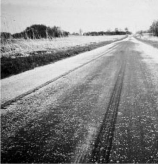
85-р зураг- Ашиглалтын 5 онооны түвшин. Хучилтын гадаргууд битум хөөрөн гарч ирсэн зам
