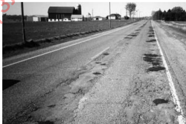
99-р зураг- Ашиглалтын 2 онооны түвшин. Дугуйн мөрний ховил үүсч, тухайн хэсэгт хучилтын бат бэх хангалтгүй болсноос хагарал үүссэн зам. Хучилтыг шинэчилж бат бэхийг дээшлүүлэх шаардлагатай.
