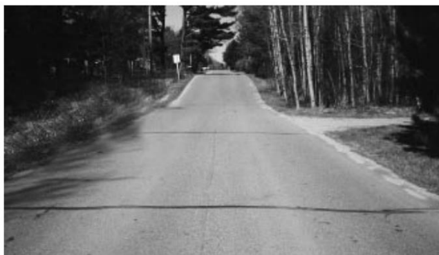
76-р зураг- Ашиглалтын 7 онооны түвшин. Дагуу ба хөндлөн хагарлыг бөглөж арчилсан зам.
