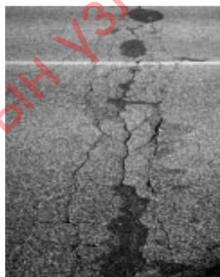
49-р зураг- Хөндлөн хагарлын завсараар ус орж, хучилтыг эвдэн хоёр хагарал үүссэн байдал.
